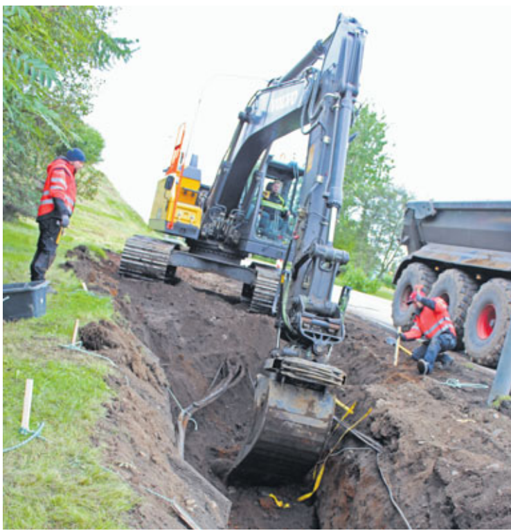
Orkupörf hitaveitunnar hefur tvöfaldast frá árinu 2000. Hitaveitukerfið var upphaflega hannað með það í huga að aðveitulagnir kæmu sunnan úr Eyjafjarðarsveit. Árangurslaus borun á vinnslusvæði við Botn sumarið 2016 varð til þess að ákveðið var að afla vatns fyrir veituna á Hjalteyrarsvæðinu svo mæta mætti aukinni þörf fyrir orku.
