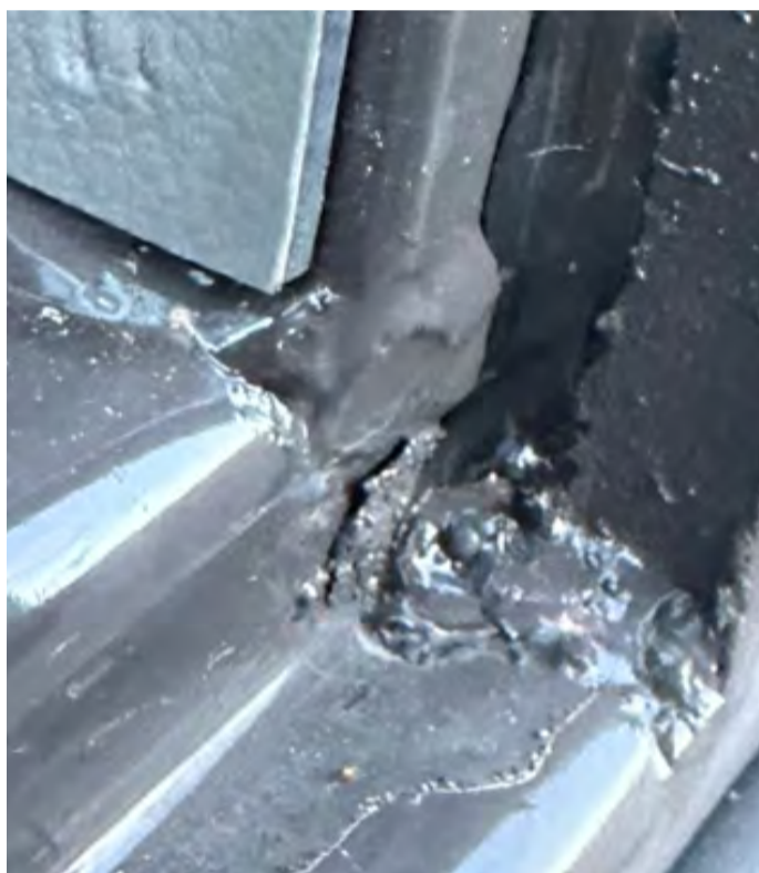
Hér sést léleg málmstuða á veltigrind sem kittað hefur verið yfir.
