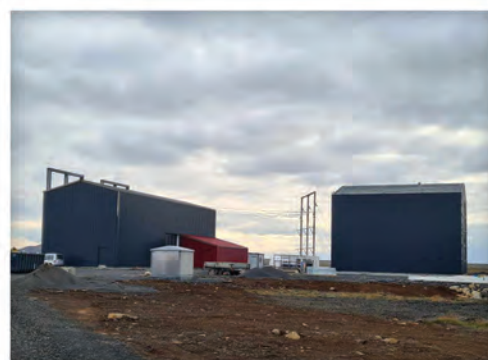
Landsnet hf. - 560m 2 - Alverk Njarðvíkurheiði - Keflavík- Tengivirki og spennahús - "Í vinnslu"
