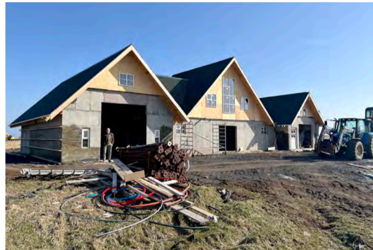
Einangrunar- og sæðingastöðin í Efra-Holtum er langt á veg komin. Byggð var tengibygging á milli tveggja gamla fjárhúsa sem voru á jörðinni.
