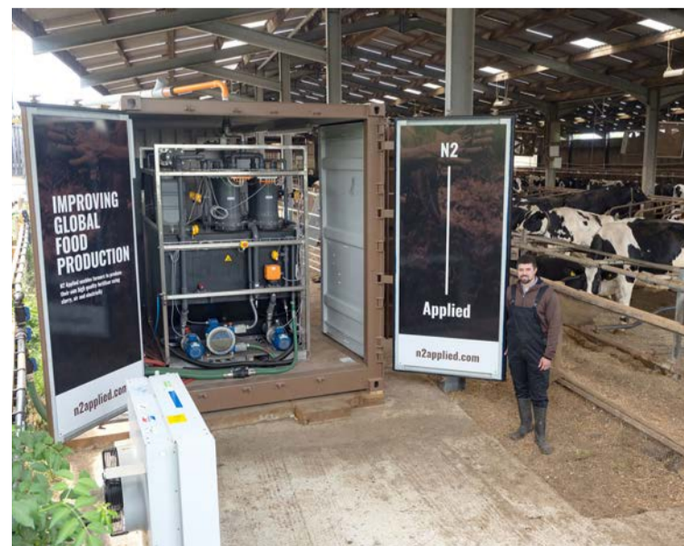
Tæknibúnaðurinn kemur í sérstökum gámi sem er auðvelt að koma fyrir á búum.
