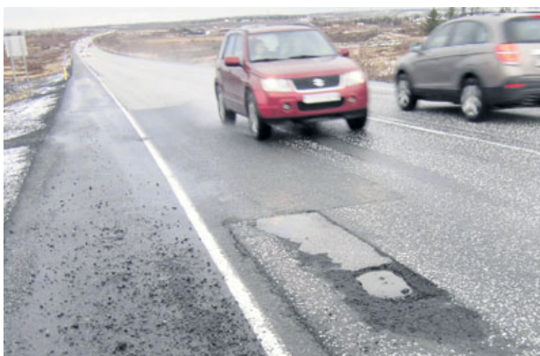
Á Þjóðvegi 1 í Lögbergsbrekkunni er hættuleg hola fyrir þá sem keyra þar á hámarkshraða.
