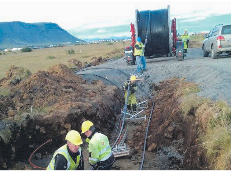
Nýi strengurinn, Selfosslína 3, er lengsti jarðstrengurinn í flutningskerfi Landsnets.
