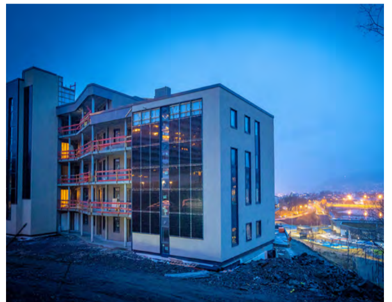
Blokkin við Slettebakken í Bergen er einstök bygging þar sem sólarcellur á þaki og framhlið hennar munu framleiða rafmagn til meðal annars að hlaða rafmagnsbíla og sameiginlegt kæliherbergi fyrir íbúa.
