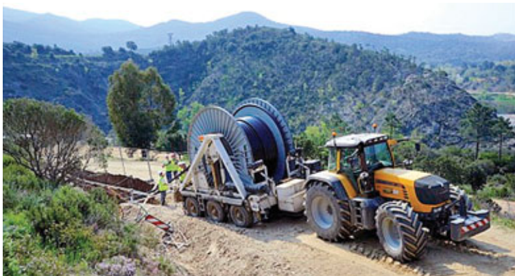
Lagning jarðstrengja fer vaxandi í Frakklandi.
